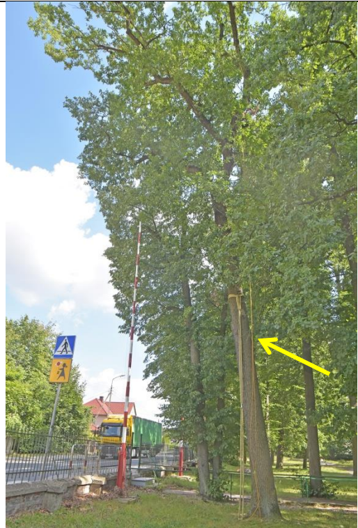
Fot. 22.2. Dąb szypułkowy nr inw. 101, Zespół Szkół nr 3 im. Mikołaja Reja w Kędzierzynie-Koźlu. Pochylenie pnia.
